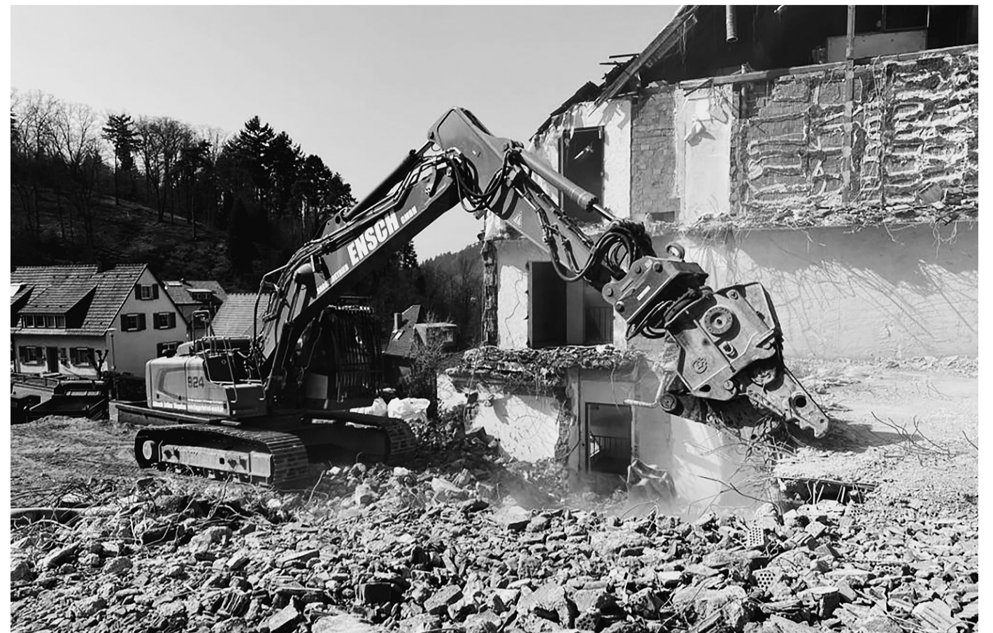
Auch beim Abriss sowie dem Baugrubenaushub eines großen Hotels kommt das Programm zum Einsatz.
