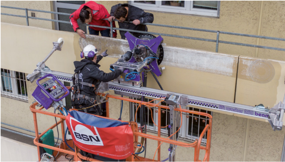
Balkonsanierung bei einem Hochhaus in Mössingen: BSN setzt bei der Sanierung auf digitale Unterstützung mit MWM-Software. | Foto: BSN GmbH + Co.KG, Mössingen
