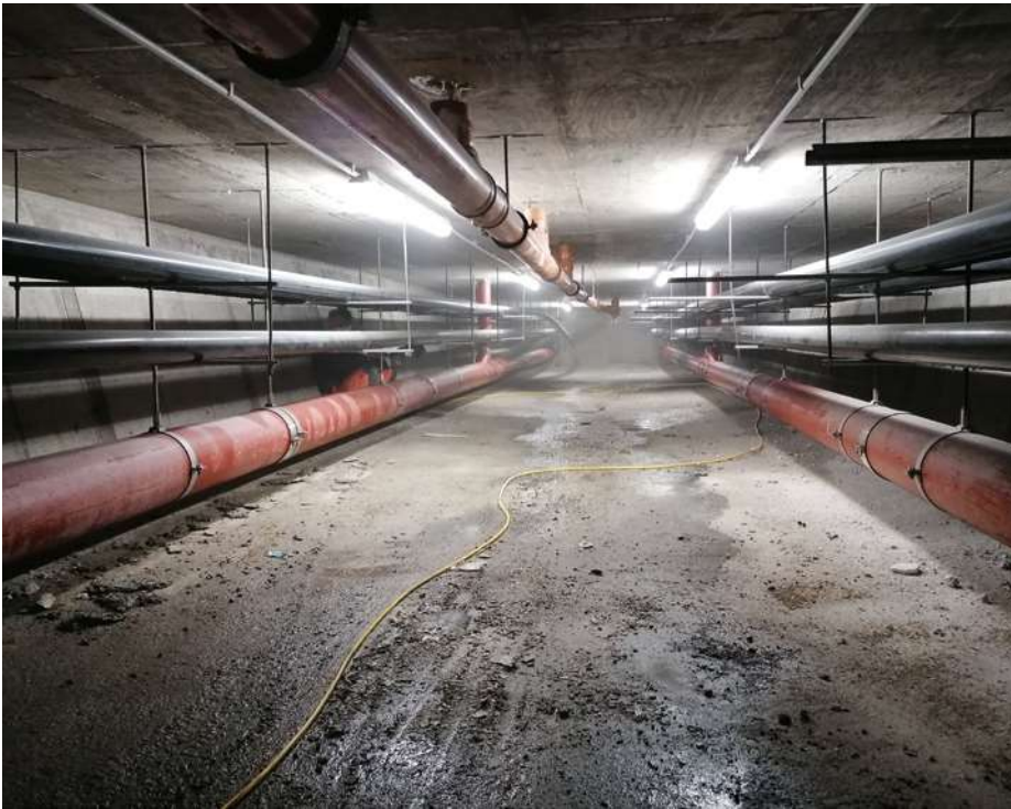
Stadtbahnbrücke in Freiburg: Zum zweiten Bauabschnitt gehört die Betonsanierung im Inneren der Hohlkästen.
